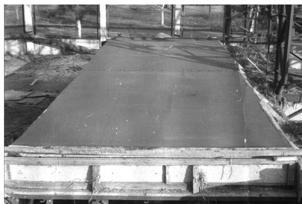
Рис. 3. Выдержка конструкции до набора бетоном монтажной прочности Fig. 3. Exposure of the structure to concrete set-up
