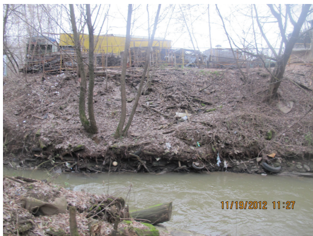
Рис. 4. Оползням по берегам нижнего течения Сетуни способствует и то, что берега сложены строительным мусором, образовавшим целые насыпи при строительстве многоэтажек в 1970-е гг. В будущем такие погребенные свалки, застроенные гаражами, источники геохимических аномалий и загрязнения
