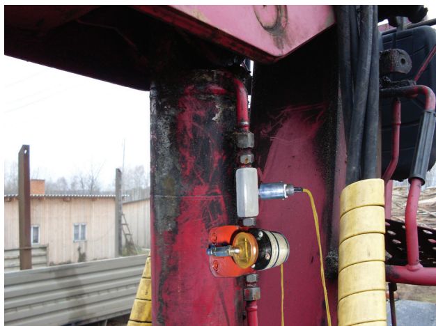
Рис. 1 Установка тензометрического датчика давления ТДД-200 и запорного клапана в гидроприводе гидроманипулятора ОМТЛ-70-02
