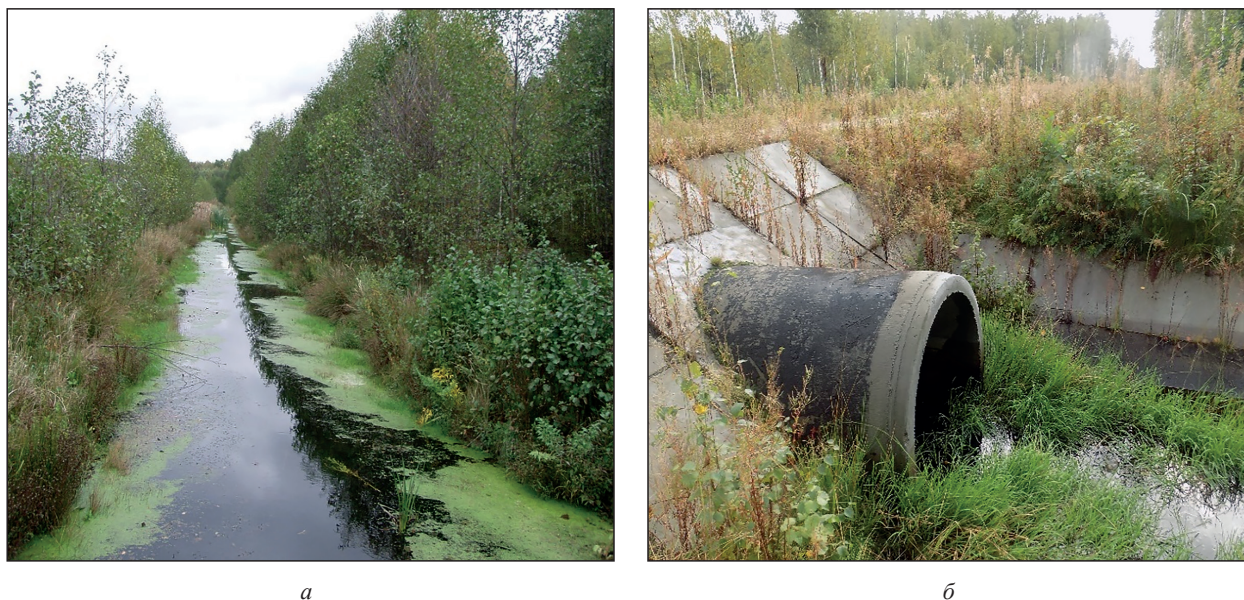
Рис. 5. Мелиоративный канал в лесном фонде при отсутствии технических уходов: а — заросший мелиоративный канал; б — заиленный откос Fig. 5. Reclamation canal in the forest fund in the absence of technical maintenance: a — overgrown reclamation canal; b — silted slope
